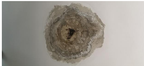
(Fig. 1.) Consecuencia de falla en un requisito funcional (estanqueidad) para losa de hormigón armado
