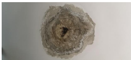
(Fig. 1.) Consecuencia de falla en un requisito funcional (estanqueidad) para losa de hormigón armado
